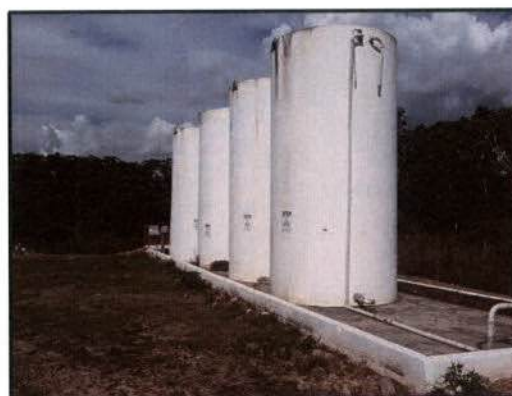
Figura 3 - Módulos Anaeróbios – ETE Industrial.
