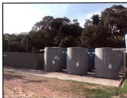
Figura 5 - Vista dos módulos de tratamento – ETE "C"
