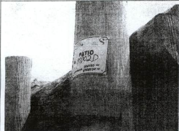
Figura 03: Foto digital de placa da pátio P1D02. Detalhe de vestígio da linha de inundação na escora da pilha.
