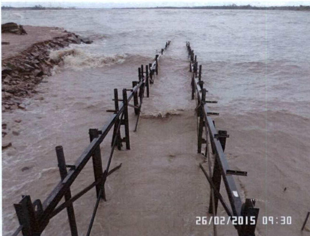
Foto 2– Situação do STP metálico em 26 de fevereiro de 2015.
