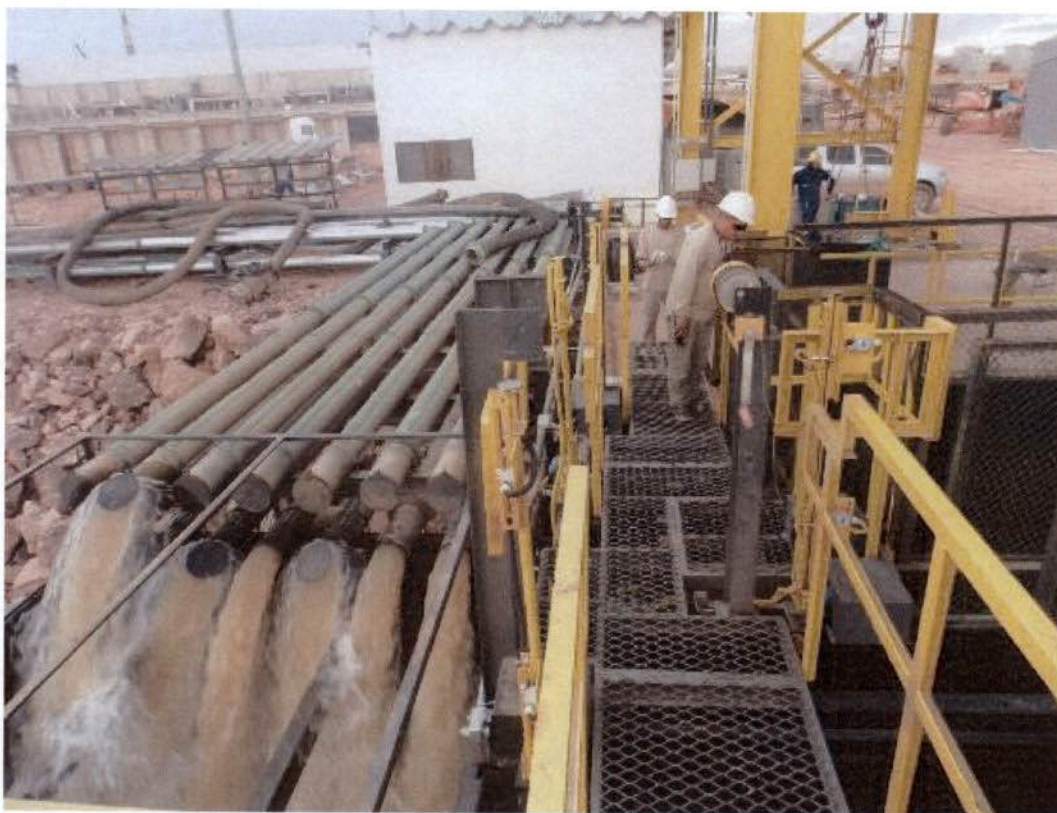
Foto II: Estruturas do STP-2 e tubulações de captação de água.
