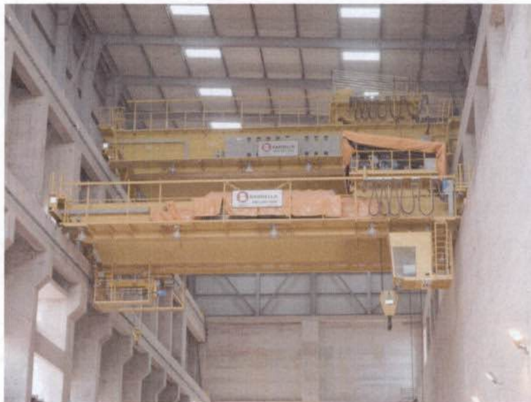
Figura 16. Pontes rolantes auxiliares (primeiro plano) e principal (segundo plano), instaladas na casa de força da margem esquerda da UHE Jirau.
