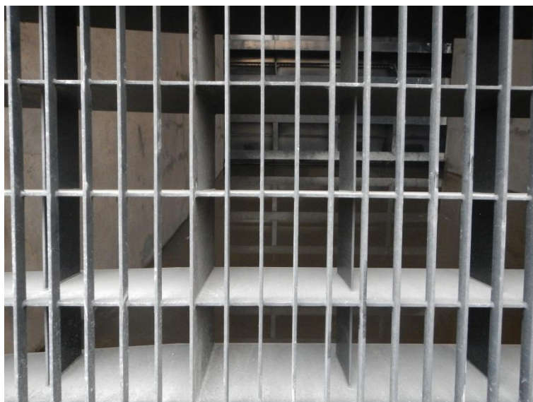
Figura 5. Detalhe das grades de proteção posicionadas na entrada das tomadas d'água do AHE Jirau.
