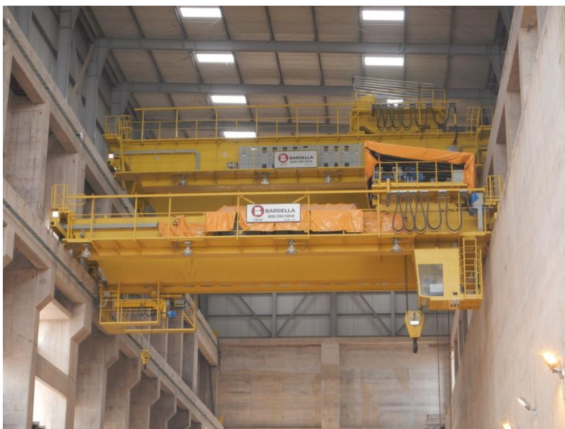
Figura 16. Pontes rolantes auxiliar (primeiro plano) e principal (segundo plano), instaladas na casa de força da margem esquerda do AHE Jirau.
