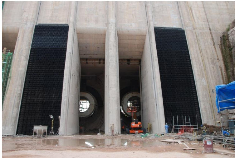
Figura 4. Vista geral das grades de proteção parcialmente montadas nas entradas das tomadas d'água de duas UG do AHE Jirau.
