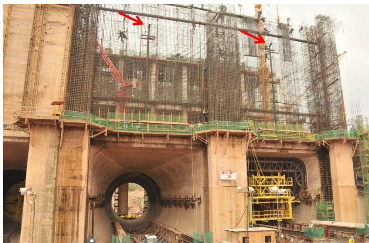
Figura 6. Dutos de alívio de pressão (setas vermelhas) em fase de montagem nas UG do AHE Jirau que serão utilizados para o acesso dos equipamentos de monitoramento da ictiofauna e da qualidade da água.
