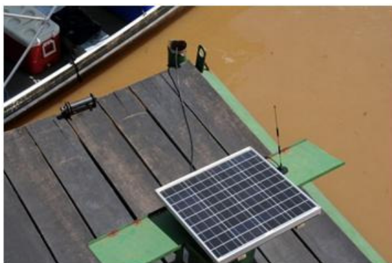
FOTO 2.9. 11: Detalhe do equipamento de monitoramento em tempo real – painéis solares e sonda sobre plataforma flutuante
