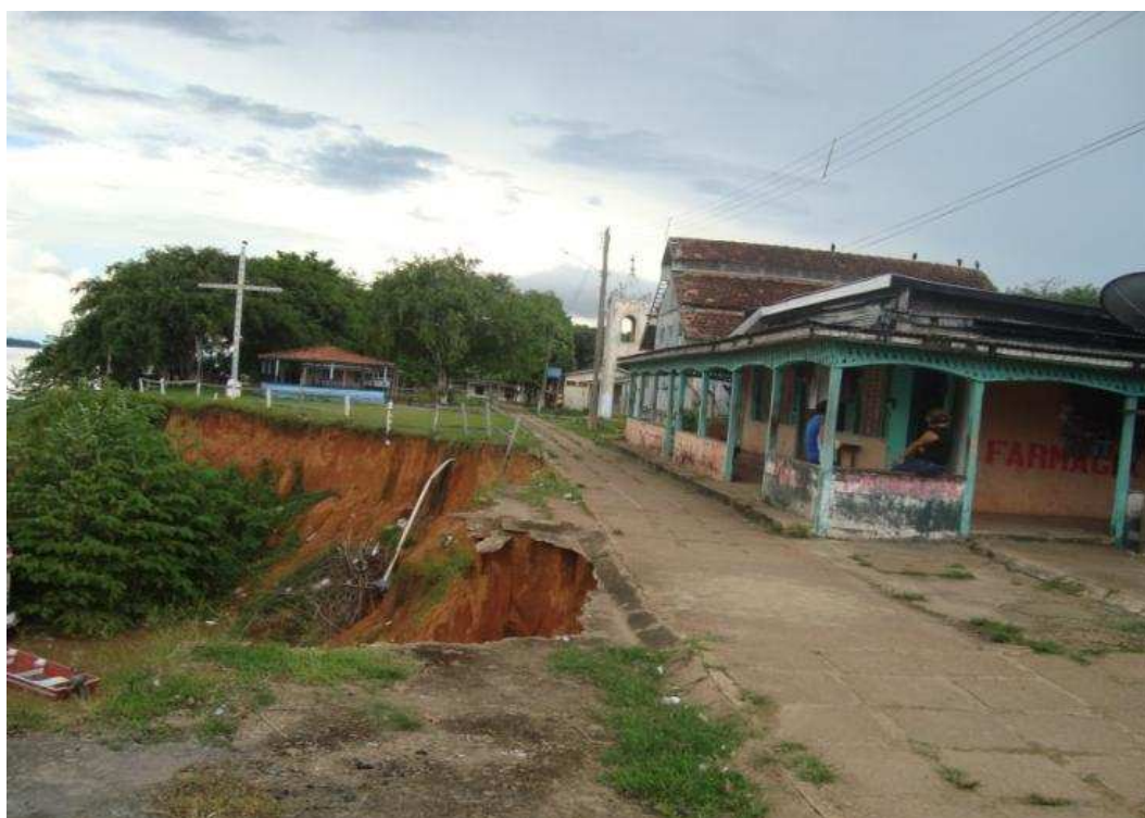
Figura 3.30. Detalhe do Processo Erosivo na Margem do Rio Madeira em Calama (Local de Monitoramento 13)
