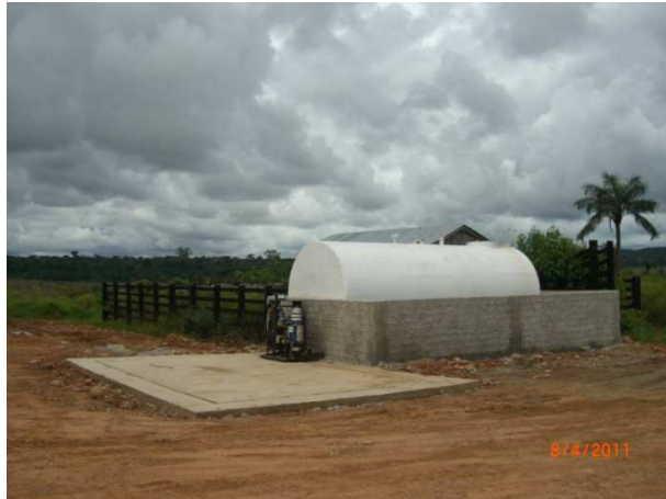
Foto 7.7 – Instalação do tanque de combustível no canteiro de obras da Rondônia Transportes.
