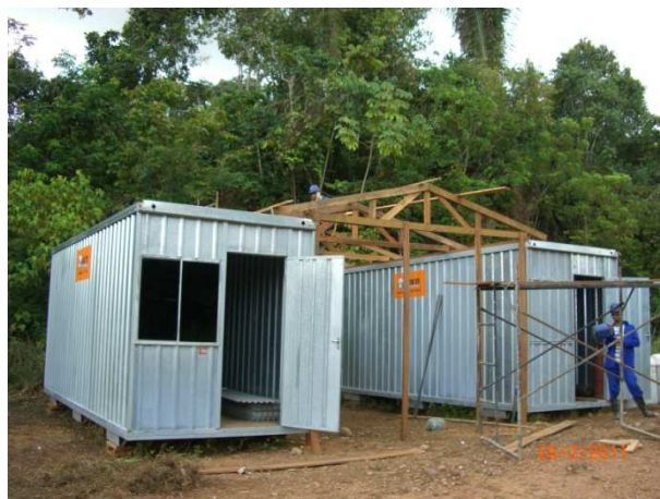
Foto 11.2 – Instalação dos contêineres e da área de vivência da empresa Benapar (fev/2011)
