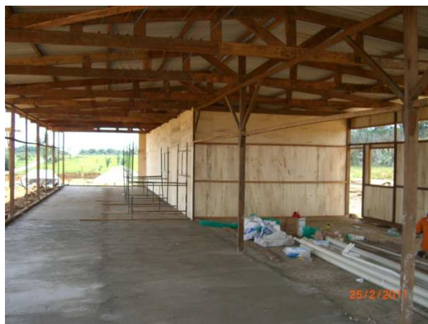
Foto 7.4 – Instalação do refeitório e do setor administrativo no canteiro de obras da Rondônia Transportes.
