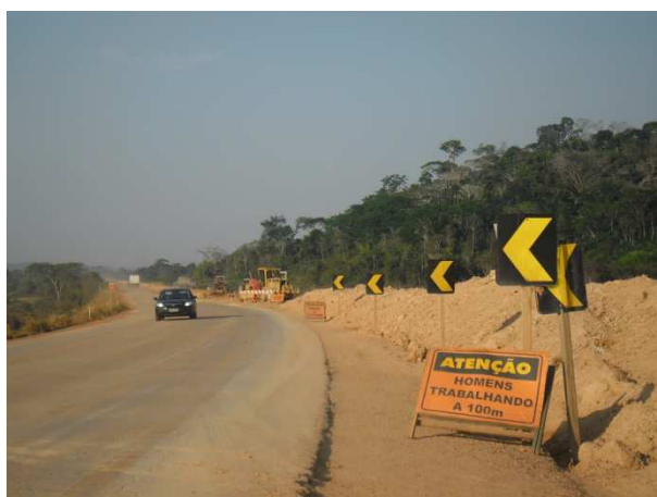
Foto 5.4 - Sinalização vertical de advertência no desvio na BR-364 (março/2011)
