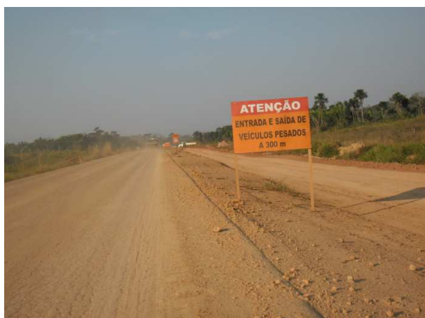
Foto 5.3 – Sinalização vertical de advertência no desvio na BR-364 (março/2011)
