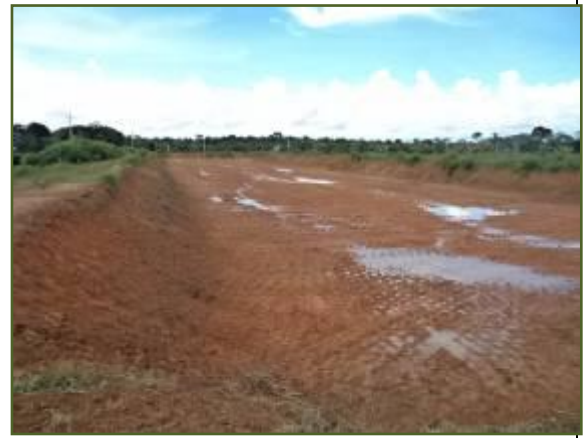
Abertura de rampa para compactação do tanque de engorda de peixes – Vista do Galpão
