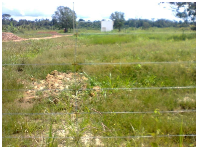
Detalhe do Aterramento das Cercas
