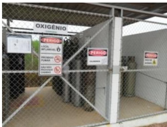
Foto 07- Depósito de Gases Inflamáveis
