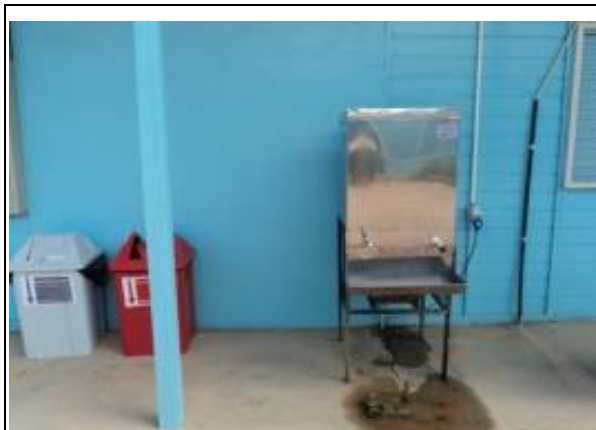
Foto 20: Bebedouro localizado na área do alojamento MD
