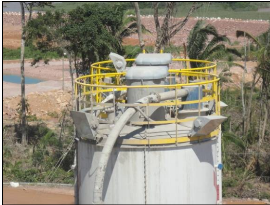
Foto 09: Sistemas controle emissões atmosféricas
