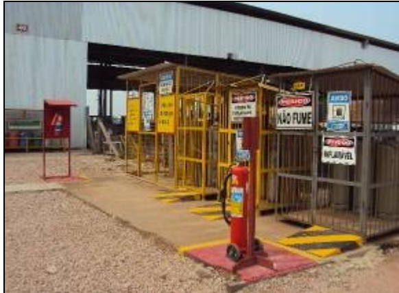
Foto 24: Armazenamento de gases
