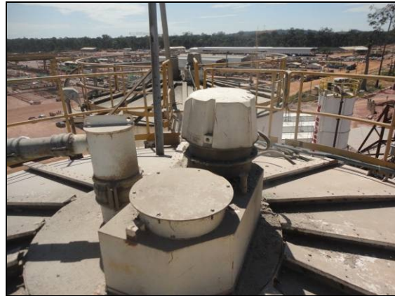
Foto 10: Sistema controle emissões atmosféricas
