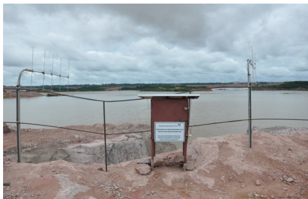
Figura 2. Aspecto de base fixa de radiotelemetria com antenas aéreas, caixa-abrigo e painel solar.
