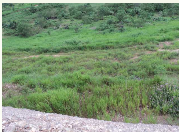
Foto 2 – Parte inferior do Talude em recuperação. RONDONMAR sub Jazida 1C Janeiro/2012
