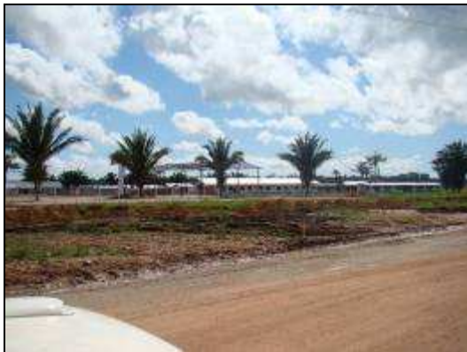
Foto 110: Local da construção da Nova Mutum Paraná - fábrica de pré moldados ao fundo. Fonte: CNEC, 2010
