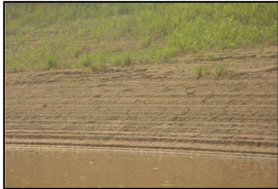
FOTO B.IV. 18 – Afloramento mostrando os sedimentos finos com restos de troncos e fraturas transversais ao acamadamento, as quais favorecem o escorregamento das camadas.
