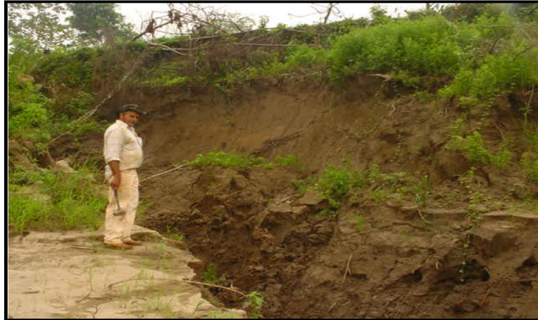
FOTO B.IV. 25 – Erosão provocada pelas águas do igarapé, afluente do rio Madeira, as quais provocam a desestabilização das camadas sedimentares de base do pacote.
