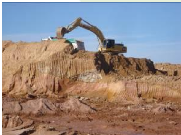
Foto 4.9.1 - Monitoramento das escavações na Casa de Força 1, localizada na margem direita (Jul/2010).
