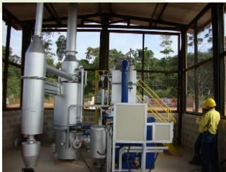
Foto 2.17.2 - Incinerador instalado no Canteiro de Obras.
