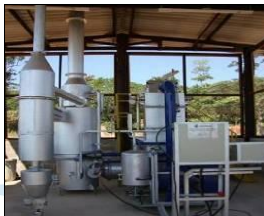
Foto 4.2.12 – Incinerador de resíduos
