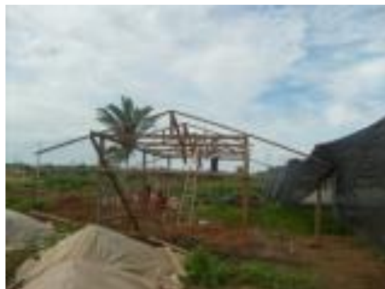
Foto 4.21.2 – Instalações da UDA de Manejo Ambiental
