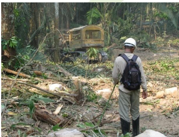
Foto 4.16.7 - Acompanhamento da supressão e resgate da fauna na margem direita do Canteiro de Obras.
