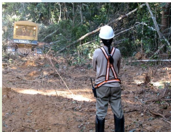
Foto 4.16.8 - Acompanhamento da supressão e resgate da fauna na margem esquerda do Canteiro de Obras.
