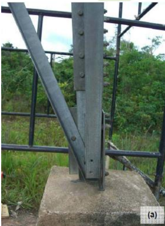
Foto 4.26.1 - Estrutura metálica de torre da LT de 230 kV sem pintura.
