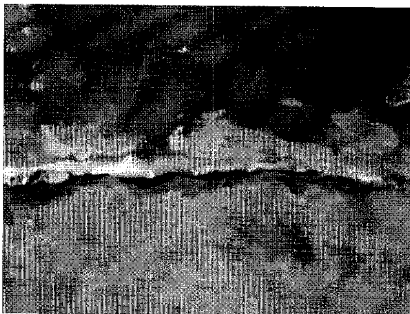
Foto 16: Vista de rachadura no piso da moradia de nº 331 na rua Porto Velho.
