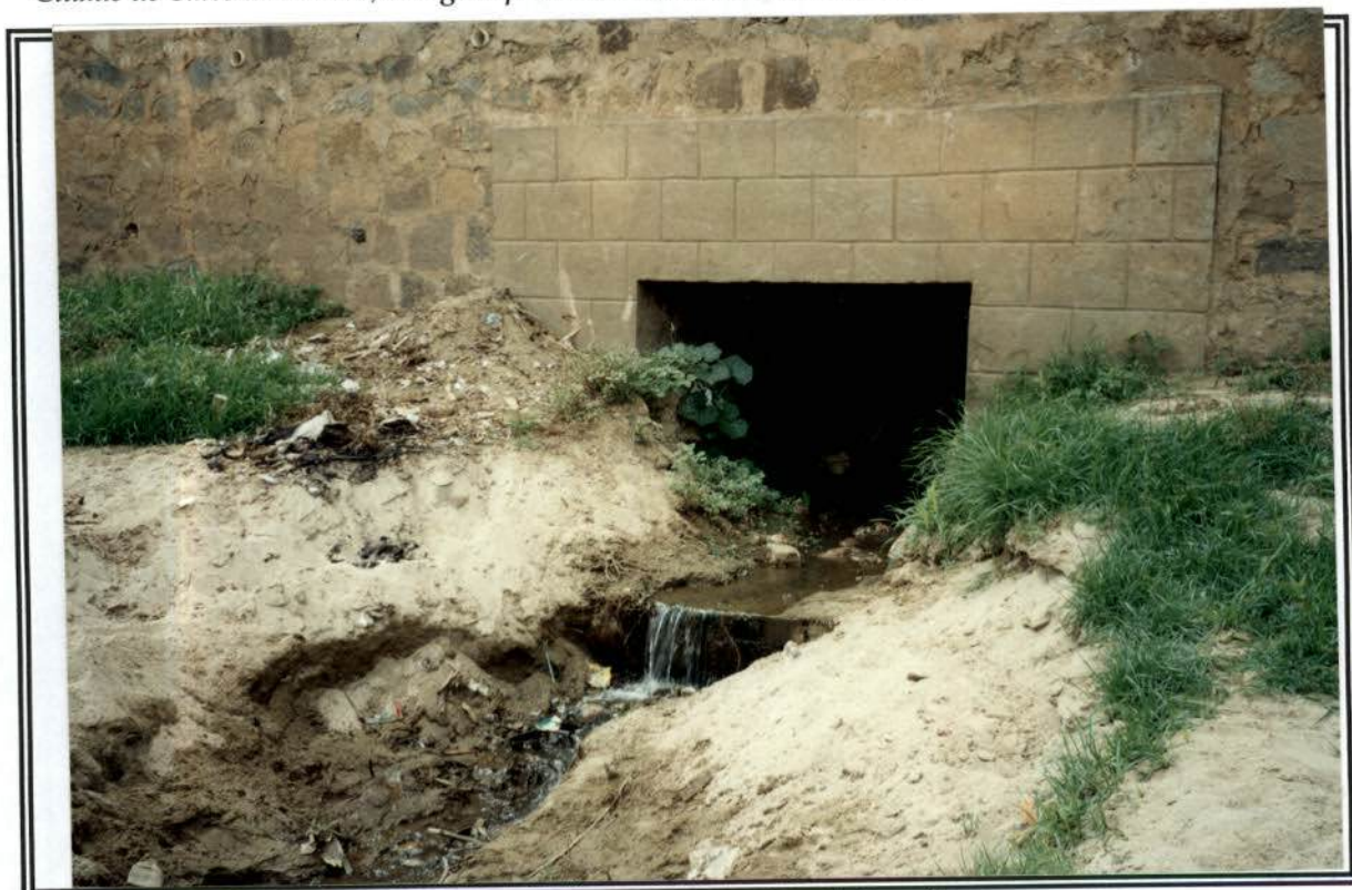
Esgoto Sanitário lançado no rio Jequitinhonha, Município de Itapebi.
