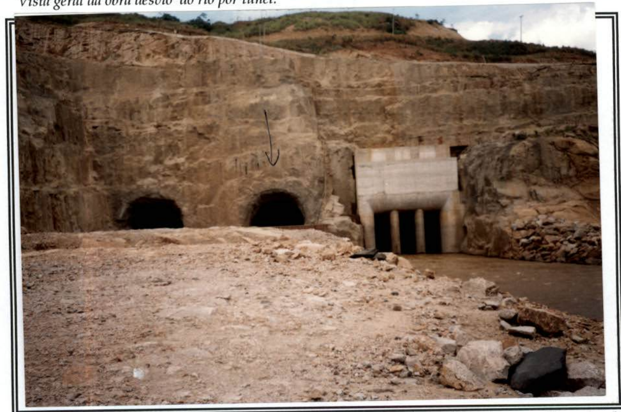
Túnel previsto para implantação da estrutura extravasadores durante o enchimento do reservatório.
