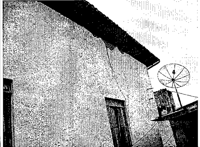
Foto 16: Sr. Ermazino Maurício dos Santos. Mora a aproximadamente 8 anos na residência. Quando mudou as trincas já existiam. Rua Clemente Martins, 173. Reclamou de carros pesados quando da execução de obras.
