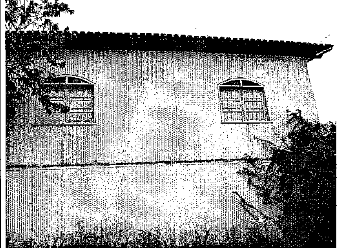
Foto 18: Detalhe de trinca na edificação.
