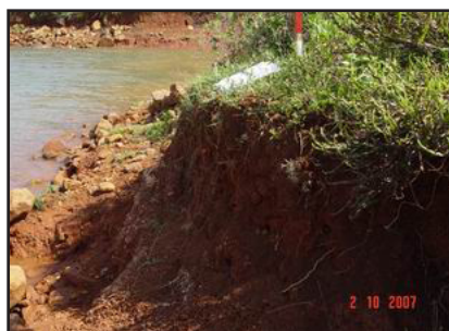
Figura 3.2 - Local F-2. Local de colocação da estaca, que recuou 8 cm desde sua colocação em Março de 2007. Fotografia: Outubro de 2007.
