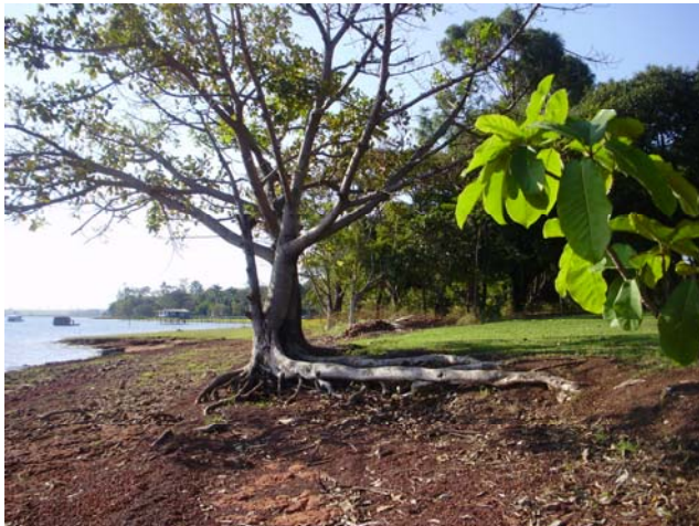
FIGURA 69 – Erosão de borda, nas margens do reservatório da UHE Ilha Solteira.
