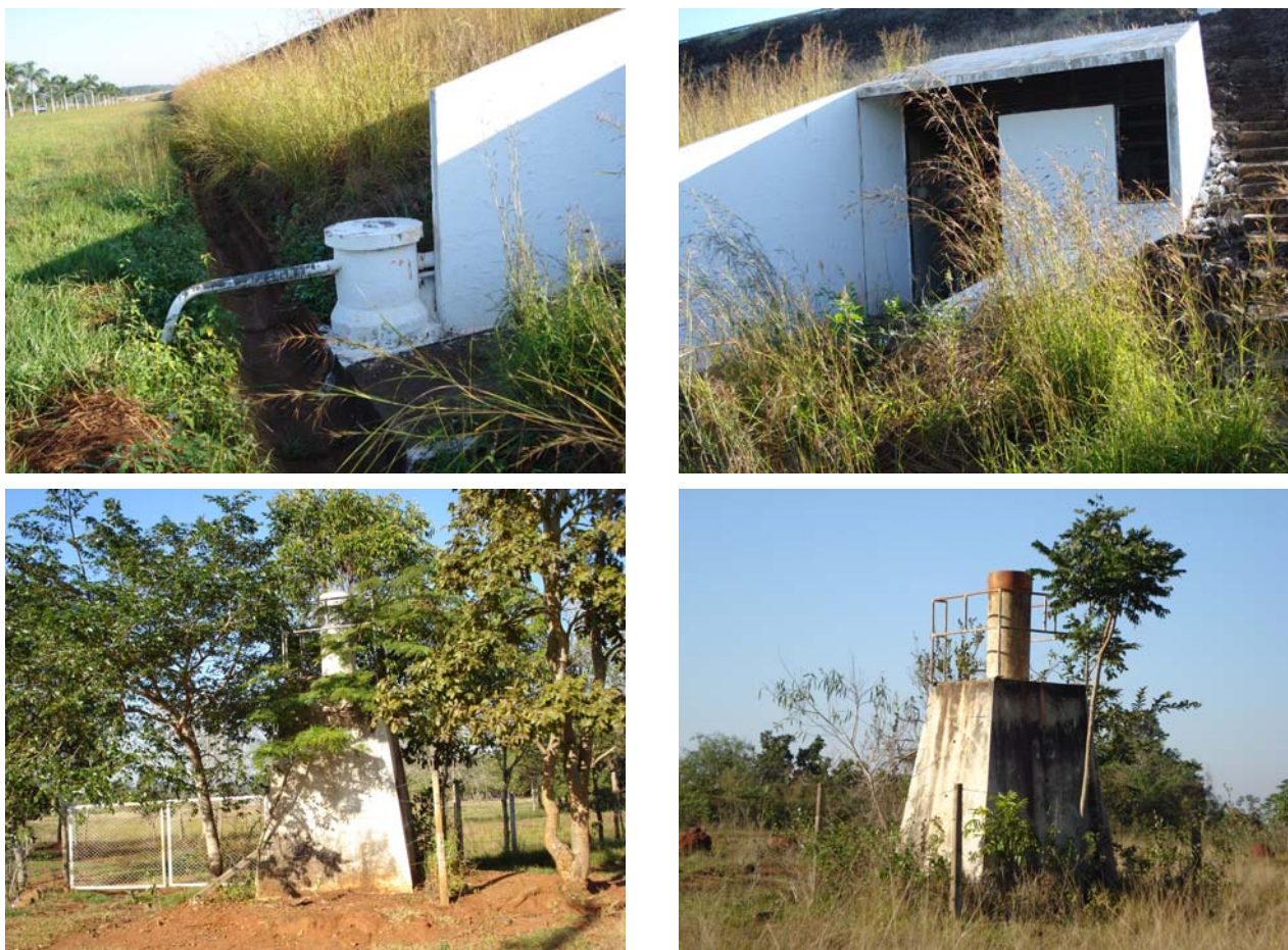
FIGURA 3 – Alguns instrumentos de auscultação e marcos topográficos que serão caiados na UHE Ilha Solteira.
