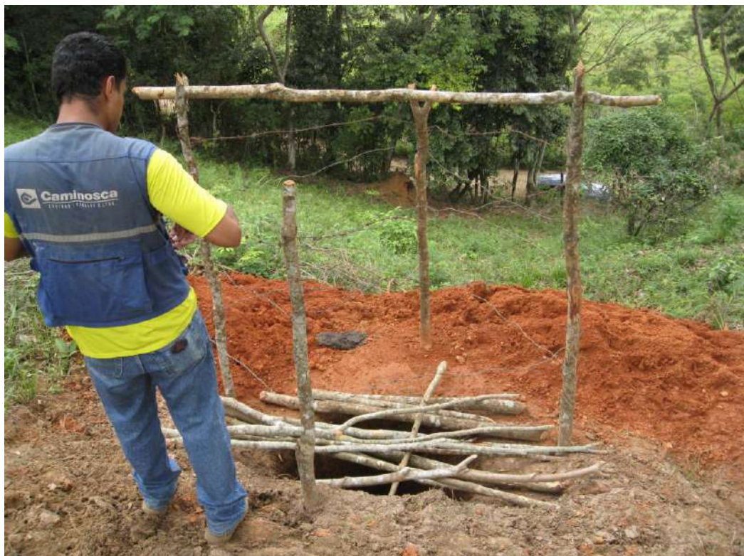
Foto 14 – Poço de Inspeção (PI-02) na margem esquerda.
