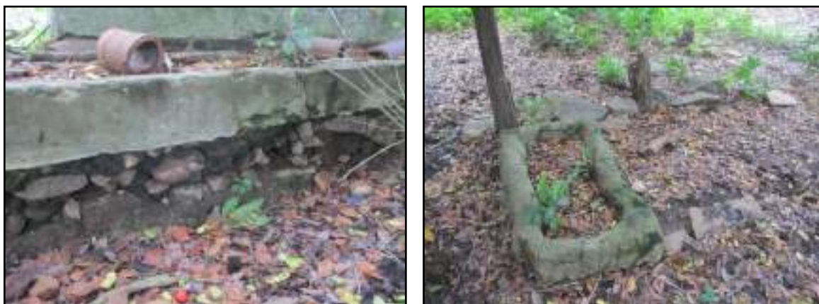
Figura 3.2.2.4 – Detalhes da presença de pedras e cimento nas estruturas construtivas. Coordenadas UTM 781597 E, 7596023 N.
