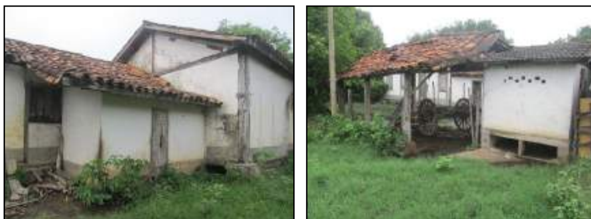
Figura 3.2.2.2 – Área posterior da sede e cobertura de telha capa e canal. Coordenadas UTM 781597 E, 7596023 N.
