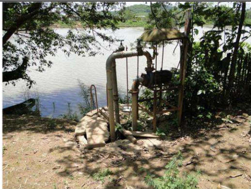
Figura 45: Captação de água para abastecimento do distrito de Batatal, out/15. Fonte: Relatório Consolidado Fase Pré-Obra, 2017.
