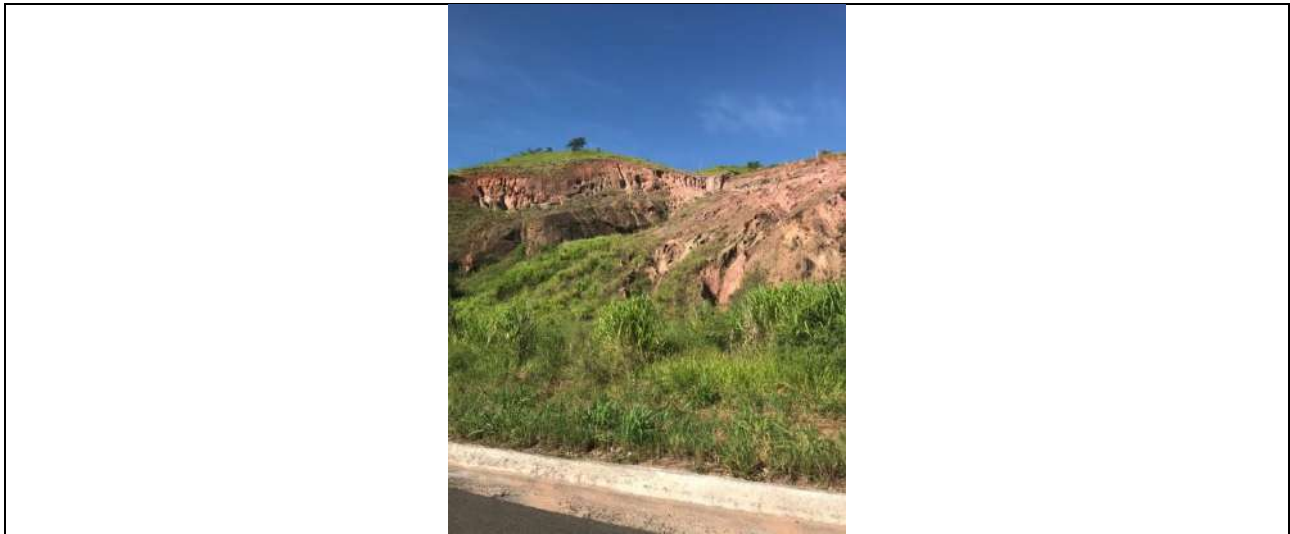
Figura 42: Erosão concentrada em sulcos identificada na All do empreendimento. Data: 28/01/2019.
