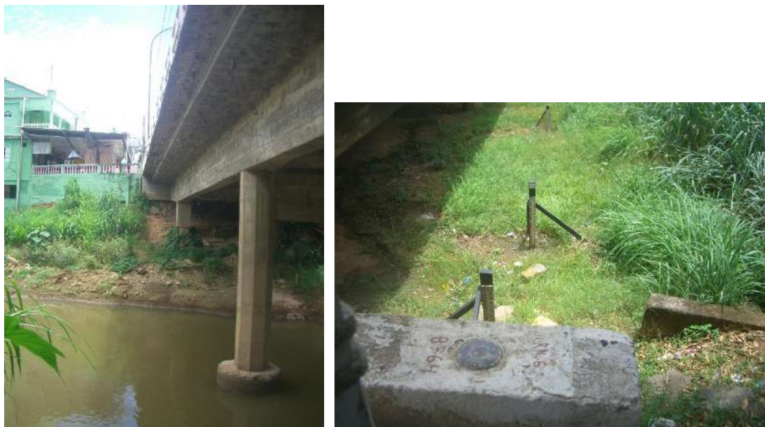
Figura 9 – UHE Itaocara I Rio Pirapetinga – Propõe-se instalar a estação no local onde é operada pela ANA a Estação Fazenda da Barra (58670002)
