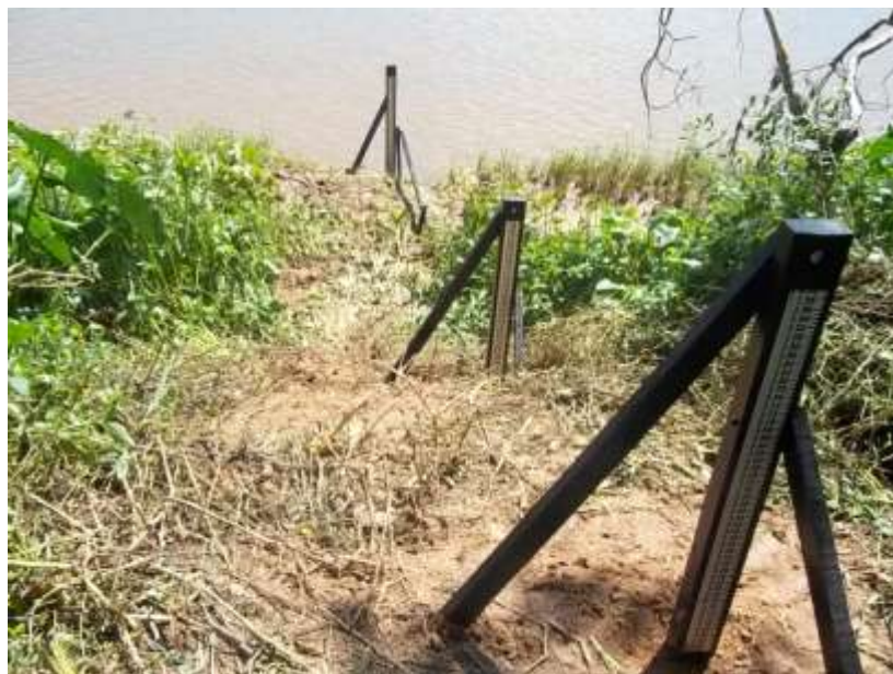
Foto 11 – Vista dos lances de réguas no local de instalação da estação Itaocara Canal de Fuga ME no rio Paraíba do Sul.
