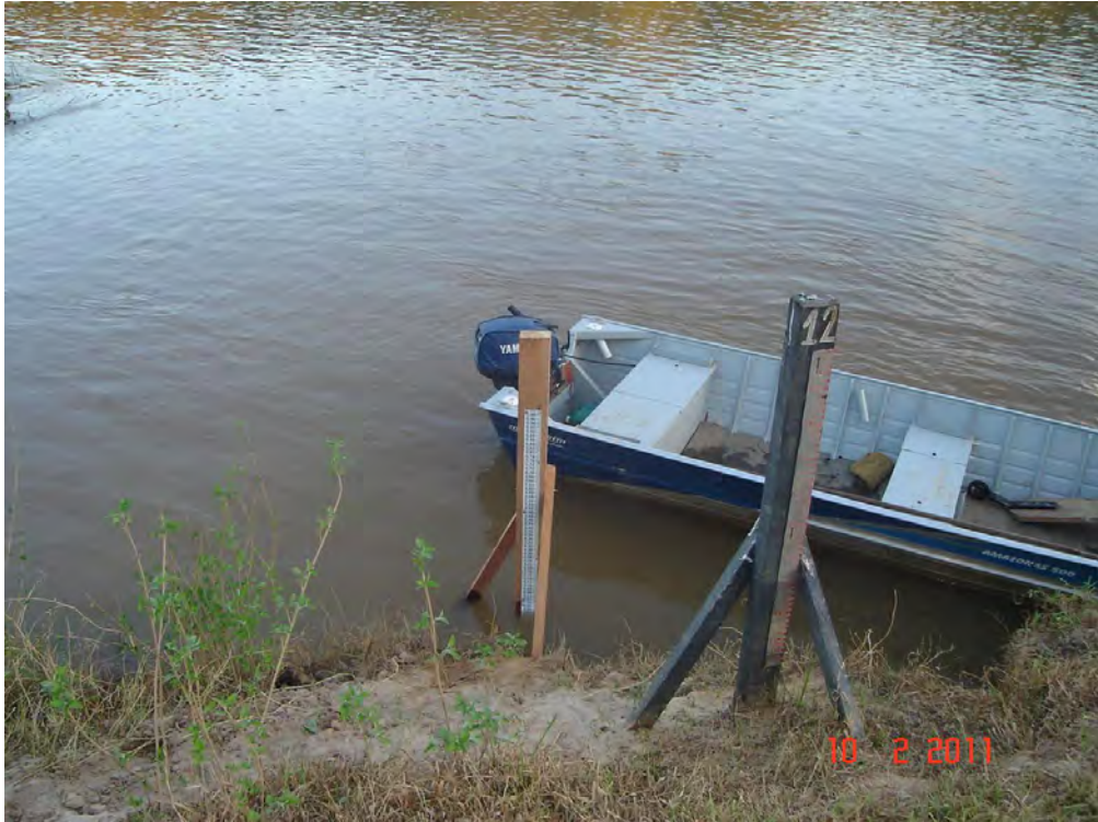
Foto 11 - Reinstalação do lance de réguas 09,00 a 11,00 da estação fluviométrica de Itaocara II Formiga Jusante.
