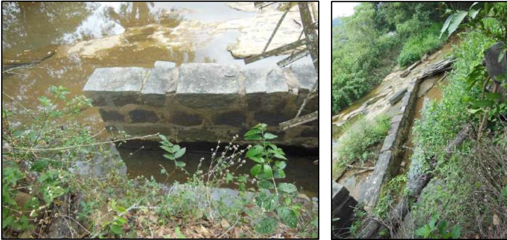
Figura 3.4.2.1.2.3 – Muretas de desvio da água do rio Paraíba do Sul. Coordenadas UTM 776400 E, 7593400 N.
