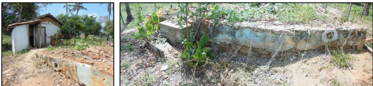
Figura 3.4.1.3.22.9 – Detalhe de alicerce da área desmoronada da edificação antiga. Coordenadas UTM 793891 E, 7602784 N.
