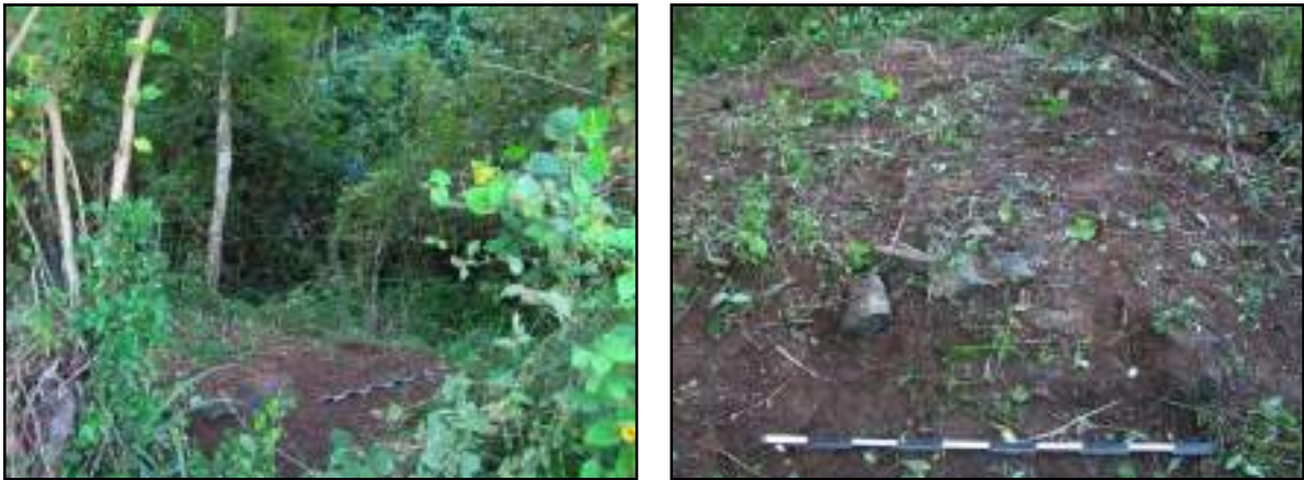
Figura 3.4.1.5.2.2 – Alicerces de pedra em área de vegetação mais fechada. Coordenadas UTM 794962 E, 7596815 N.
