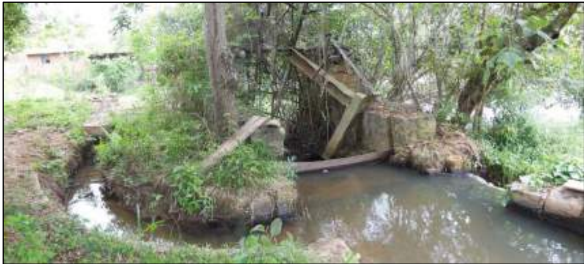
Figura 3.4.2.2.2.3 – Roda d'água e muretas do sistema de desvio da água do rio Pirapetinga. Coordenadas UTM 782517 E, 7599834 N.
