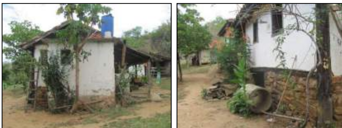
Figura 3.4.1.3.15.4 – Lateral da sede e detalhe da estrutura de alicerce de pedras. Coordenadas UTM 790943 E, 7602800 N.
