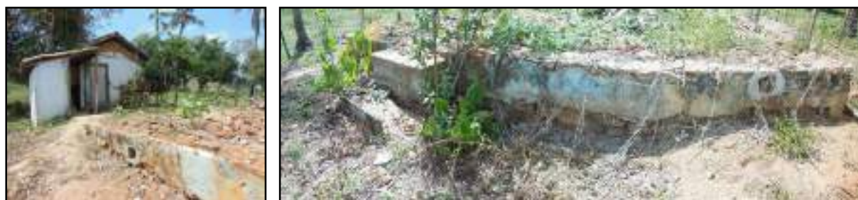
Figura 3.4.1.3.22.9 – Detalhe de alicerce da área desmoronada da edificação antiga. Coordenadas UTM 793891 E, 7602784 N.
