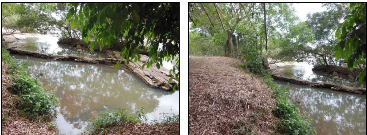
Figura 3.4.2.1.3.4 – Muretas de desvio da água do braço do rio Paraíba do Sul. Coordenadas UTM 77762 E, 7594172 N.
