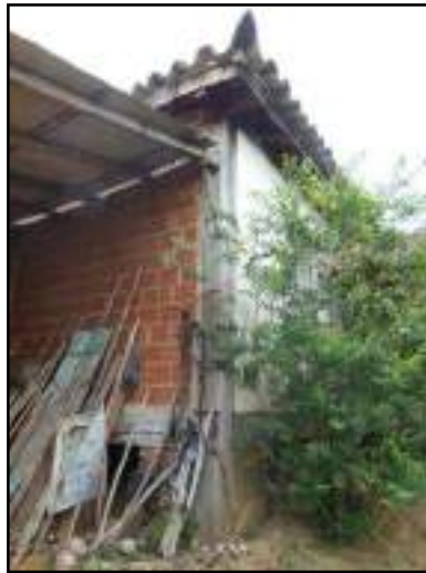
Figura 3.4.1.2.12.4 – Parte posterior da edificação principal com substituição da parede por material recente.
