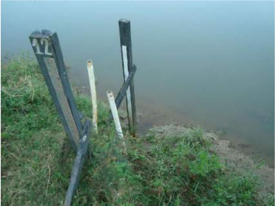
Foto 01 – Reinstalação dos lances de régua da estação fluviométrica de Fazenda Atoleiro no rio Paraíba do Sul.
