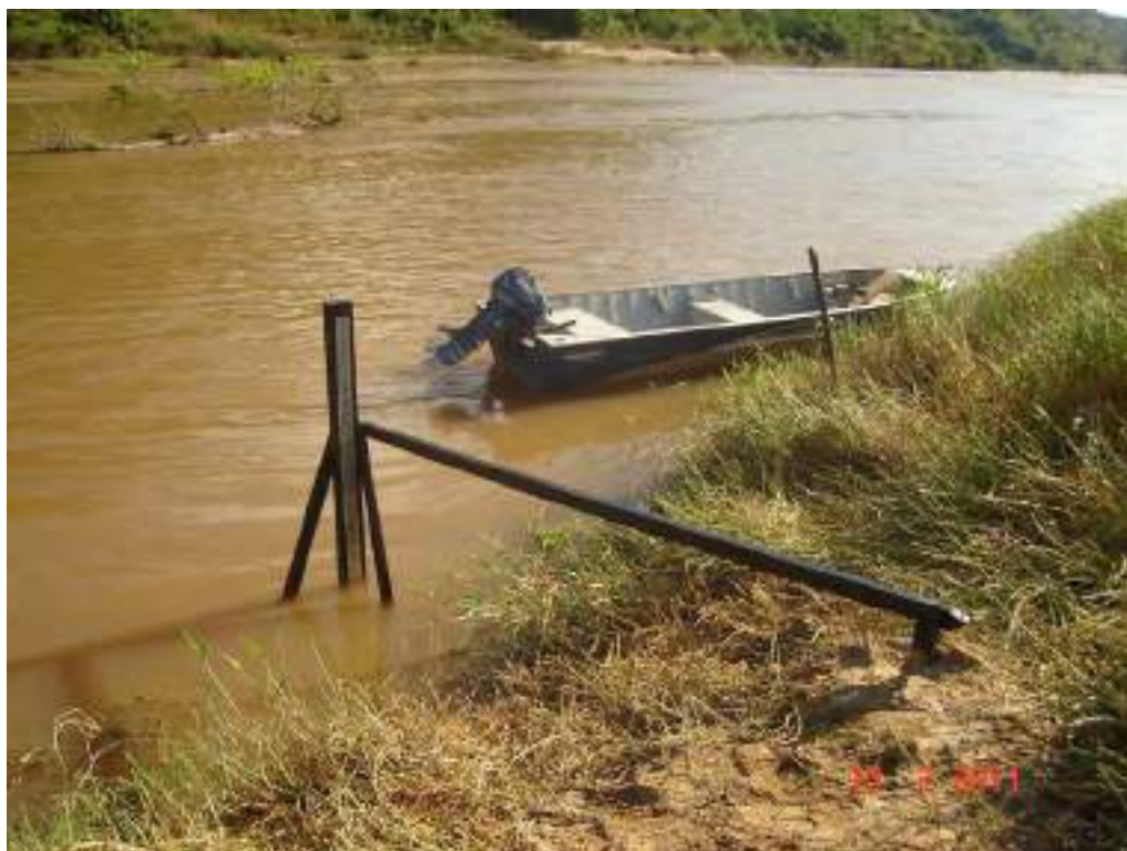
Foto 08 – Detalhe do lance de réguas 16,00 a 18,00, instalado na estação fluviométrica de Itaocara II Formiga Montante
