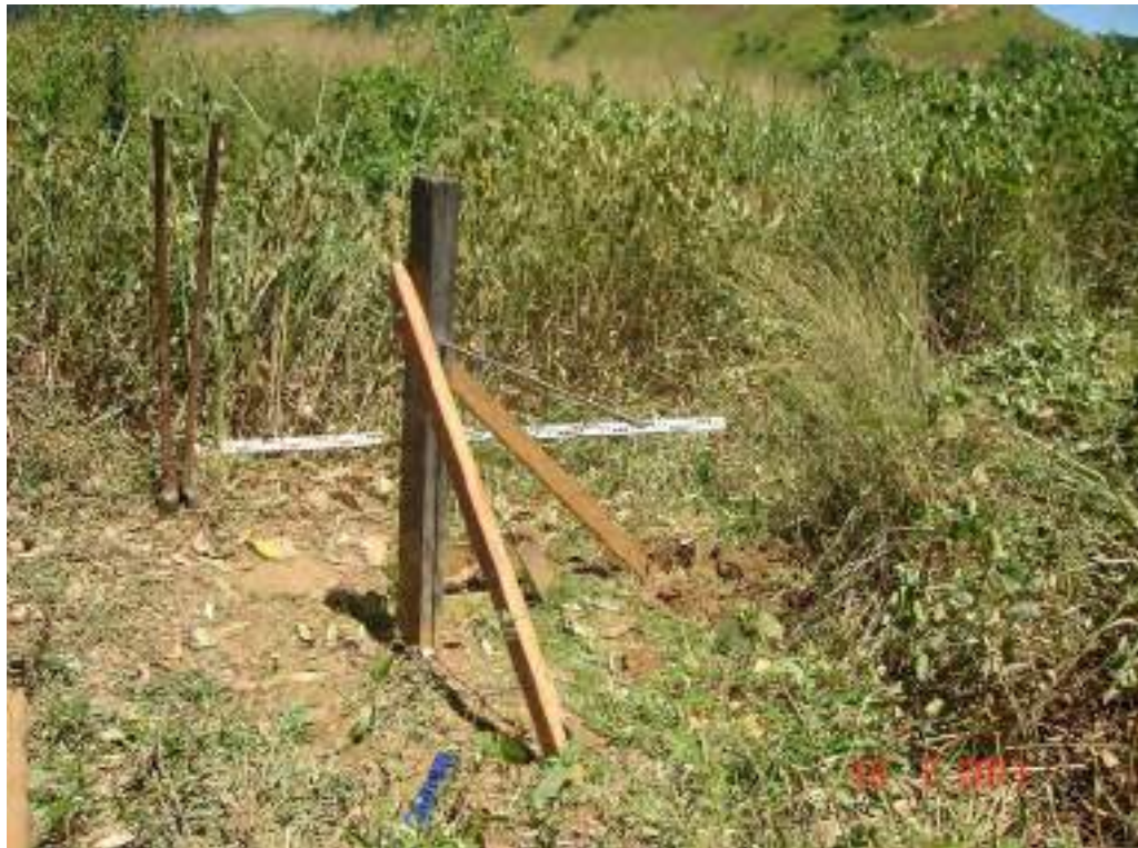
Foto 09 - Reinstalação do lance de réguas 18,00 a 19,00 da estação fluviométrica de Itaocara II Formiga Montante.
