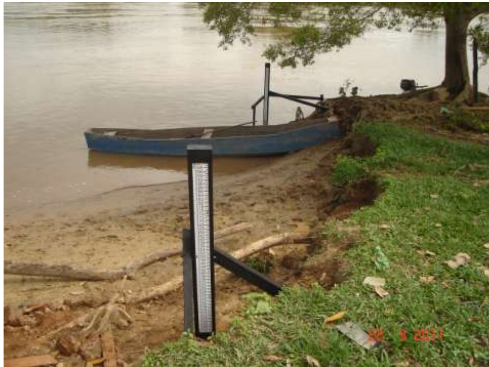
Foto 13 - Detalhe dos lances de réguas instalados na estação fluvio-sedimentométrica de Porto do Tuta no rio Paraíba do Sul.
