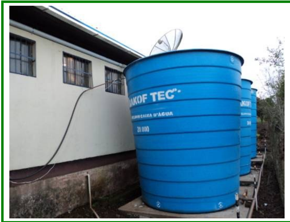
Caixas para coleta da água da chuva.
