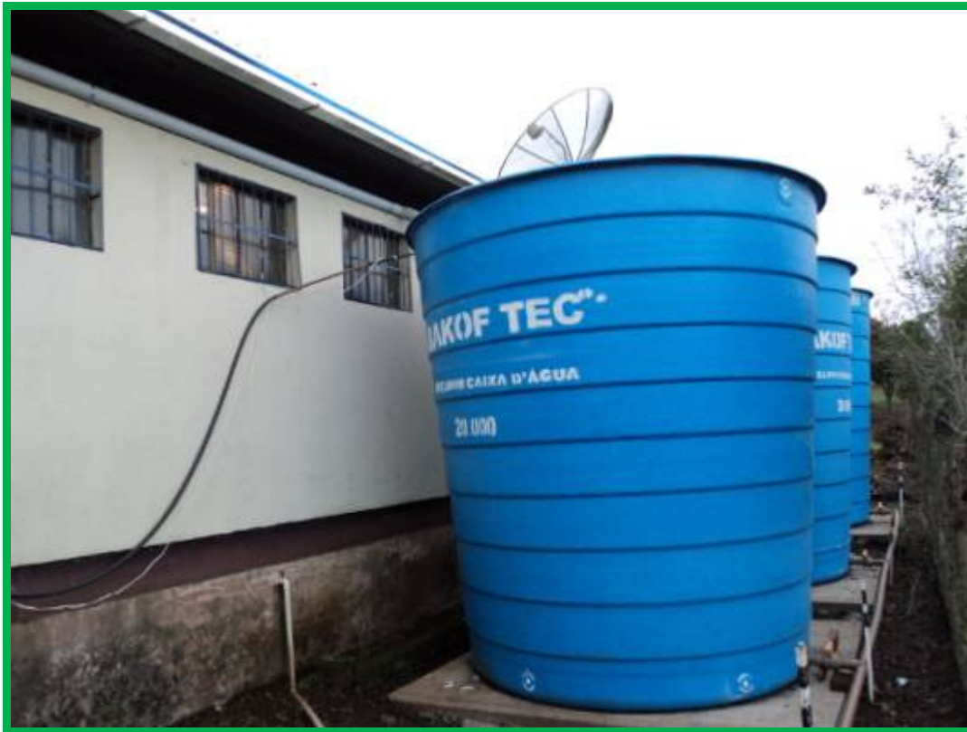
Caixas para coleta da água da chuva.
