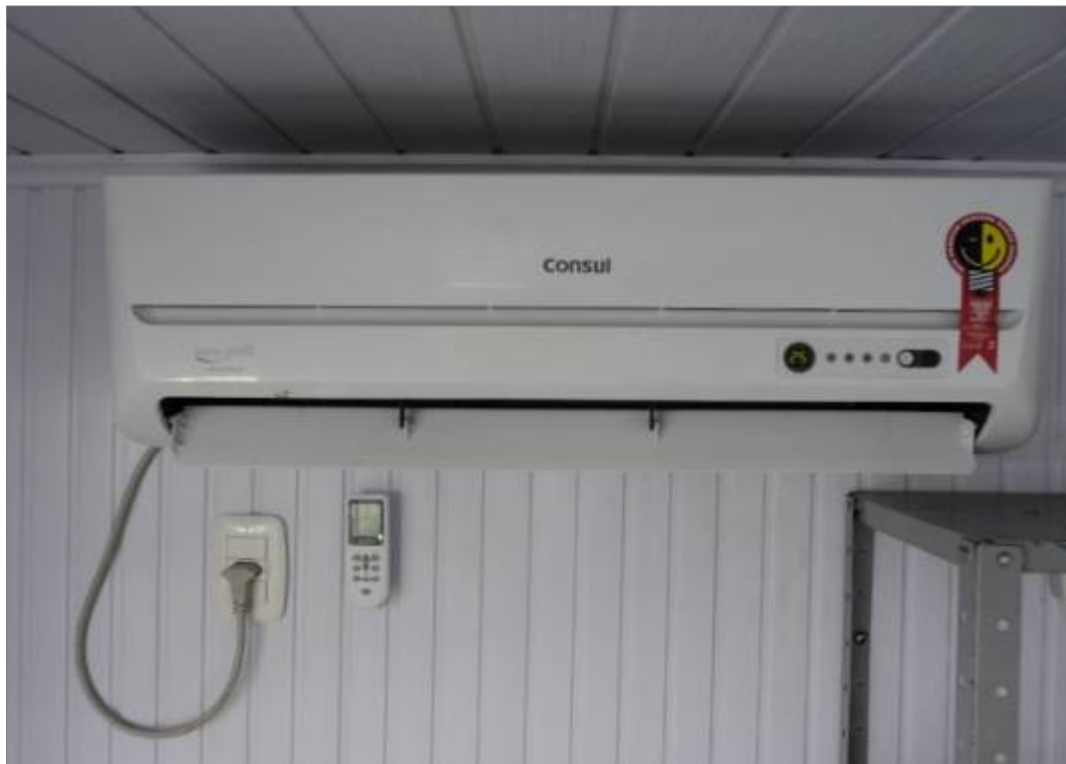
Condicionador de ar split 12.000 btus C&osil.
