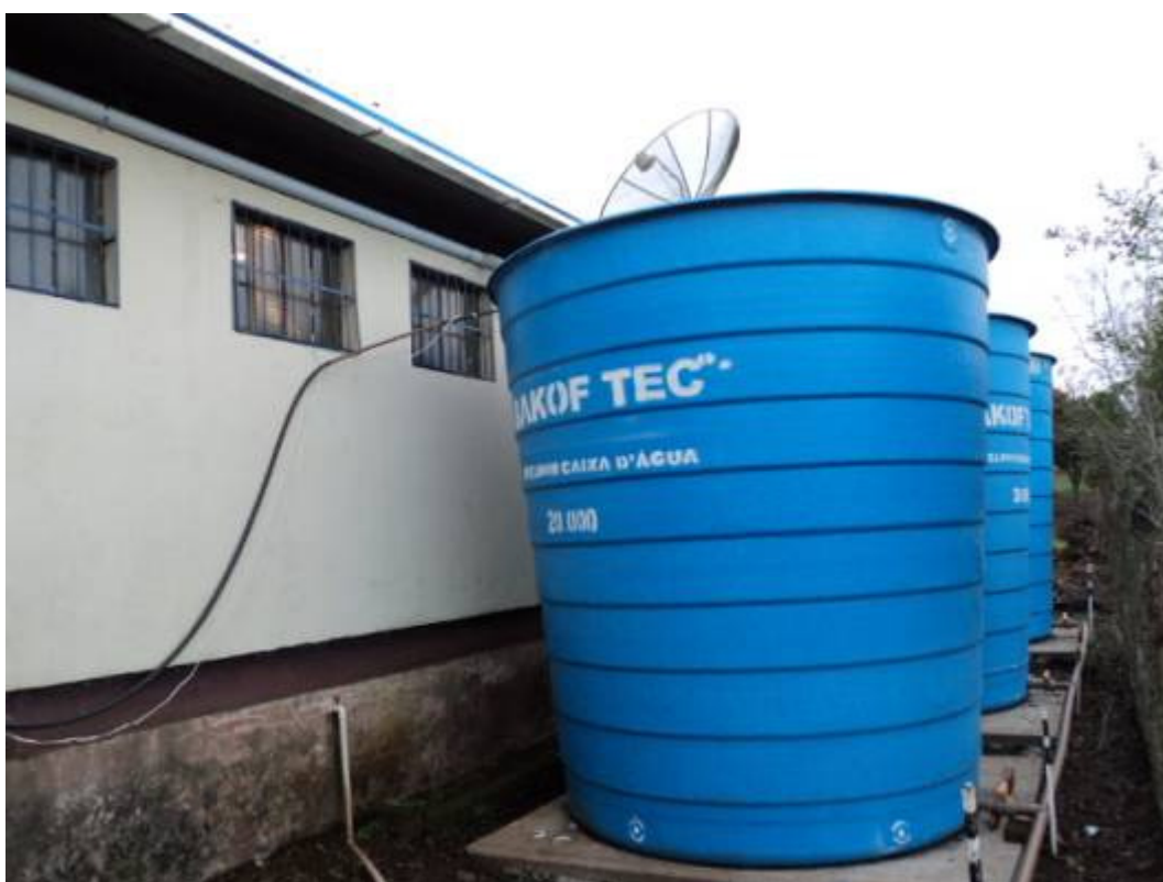
Caixas para coleta da água da chuva.
