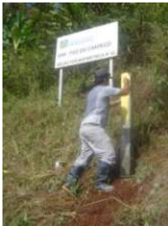
Manutenção na seção topobatimétrica nº12 , em 24/05/11.
