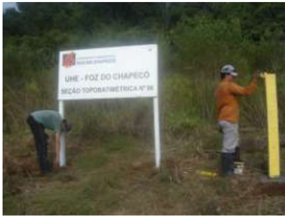
Manutenção na seção topobatimétrica nº06 , em 25/05/11.
