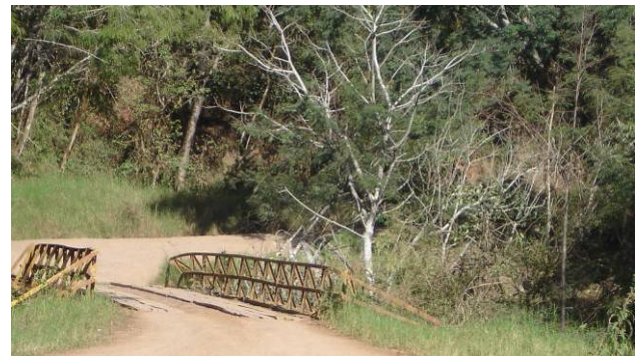
FOTO 30: PONTE A RELOCAR EM PAIAL - SC
