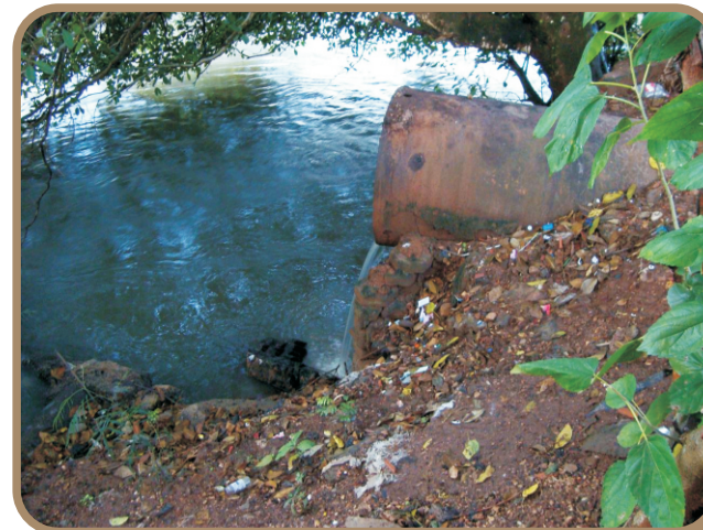
Figura 4-59: Lançamento de Esgoto Doméstico no Rio Araguaia
