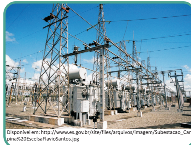
Disponível em: http://www.es.gov.br/site/files/arquivos/imagem/Subestacao_Carapina%20EscelsaFlavioSantos.jpg Figura 3-17: Exemplo de Subestação
