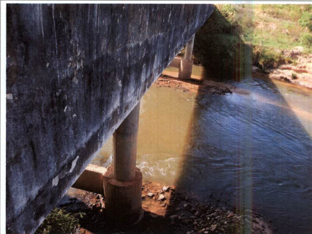
Foto 30. Vista da parte inferior da ponte do rio Babilônia, mostrando detalhe do rio. Este local está situado no final da mancha de inundação prevista, devendo sofrer efeito de remanso sem afetar a ponte.
