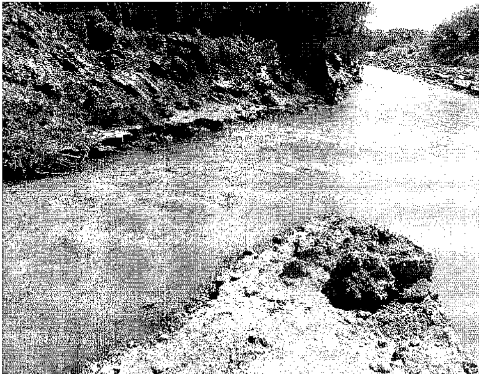
Figura 08 – Vista do Ribeirão das Antas a jusante do rompimento.
