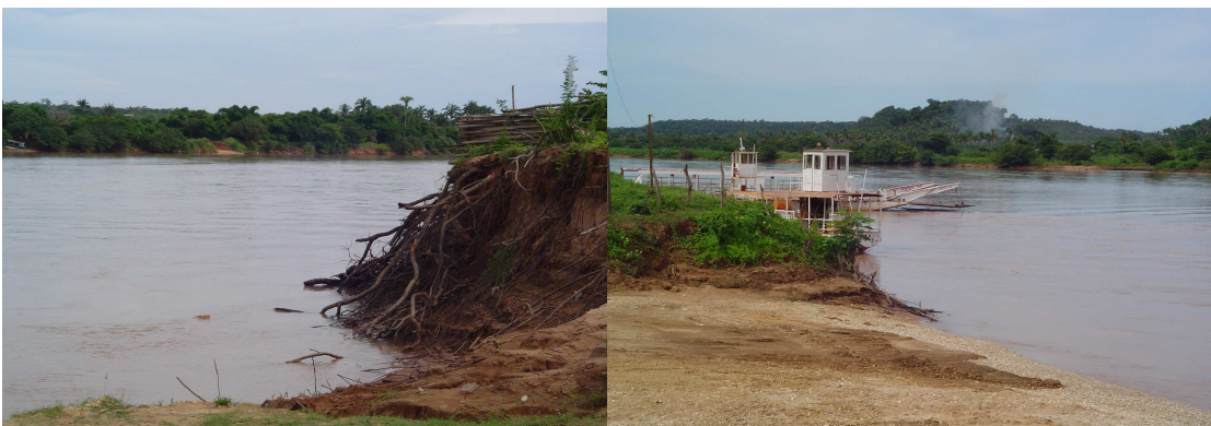
Foto 9.3.1-18 Vista da margem direita do rio Parnaíba, no local da estação CT-12. Vide erosão das margens (esquerda) e balsa usada na travessia entre os estados de Piauí e Maranhão (direita).
