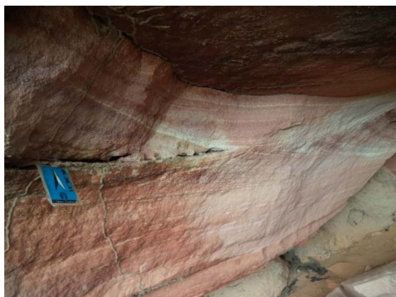
Foto 13: Formação de canaliculos em estrutura horizontal da rocha.
