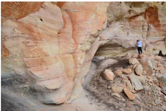
Figura 90: Vista de porção erodida do abrigo, com blocos desprendidos caídos no piso. Foto: Jonathan Caino,2014.
