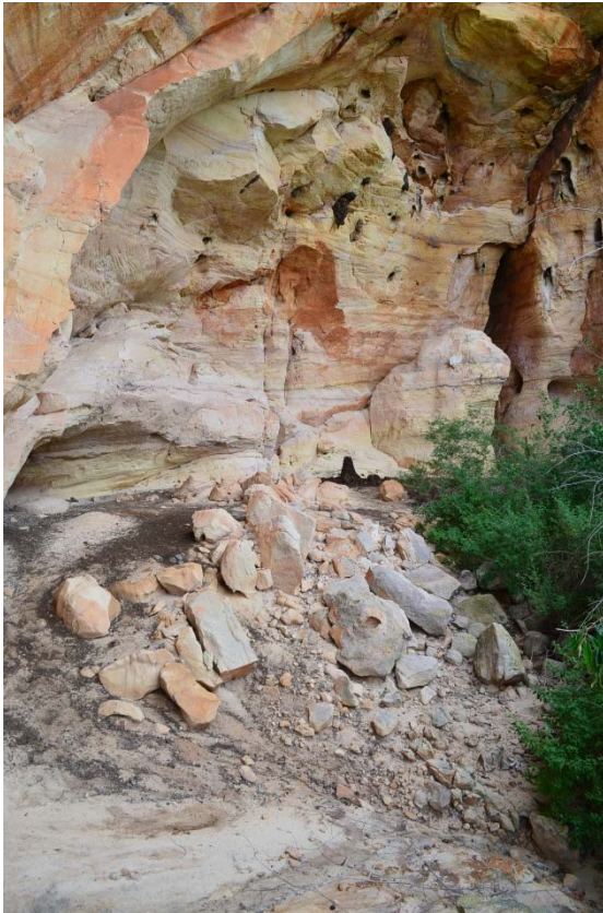
Figura 88: Blocos caídos e parede erodida. Foto: Jonathan Caino,2014.
