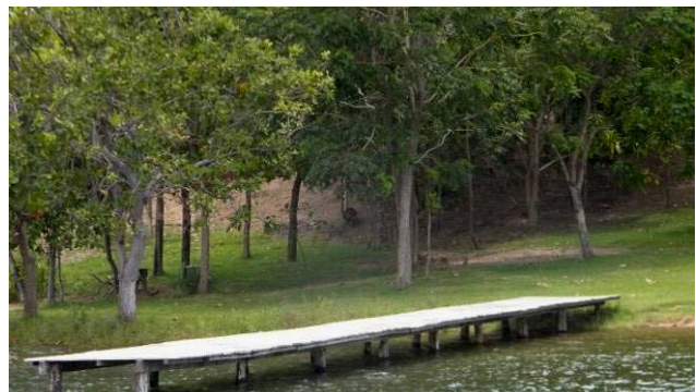
h) Vistoria de irregularidade trapiche fixo de madeira
