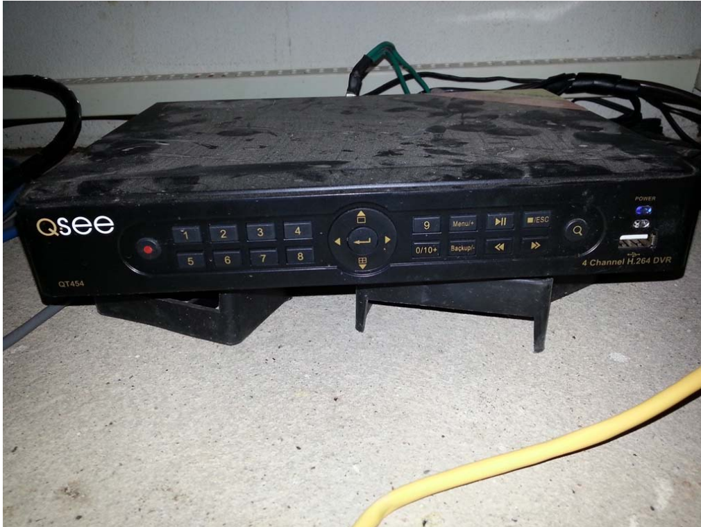
Figura 7 – DVR instalado na estação, vista frontal.
