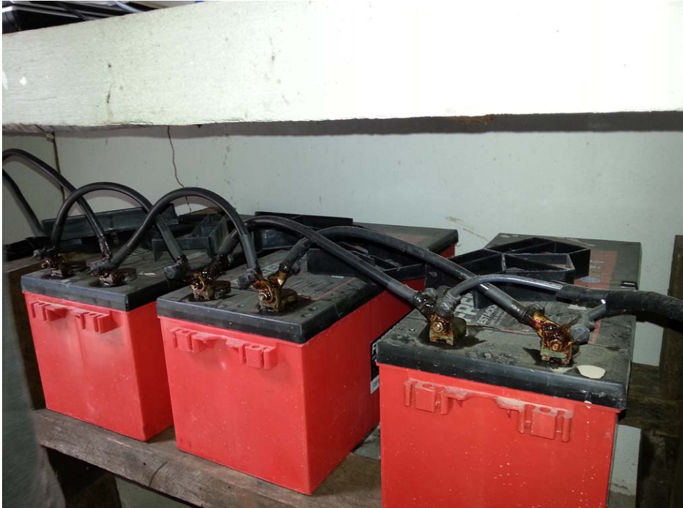
Figura 11 – Vista de três das quatro baterias da estação.
