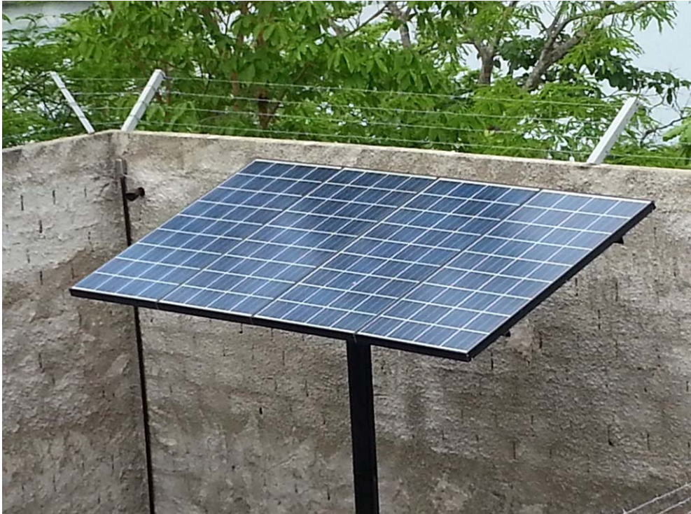
Figura 10 – Vista dos 04 painéis solares da estação.
