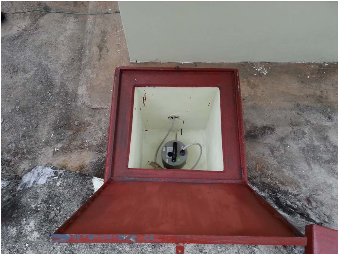
Figura 14 – Sismômetro da Estação CAN1 instalado no respectivo abrigo (foto abaixo). Nas fotos acima, procedimento de alinhamento do equipamento para o norte geográfico, utilizando-se a bússola Brunton.
