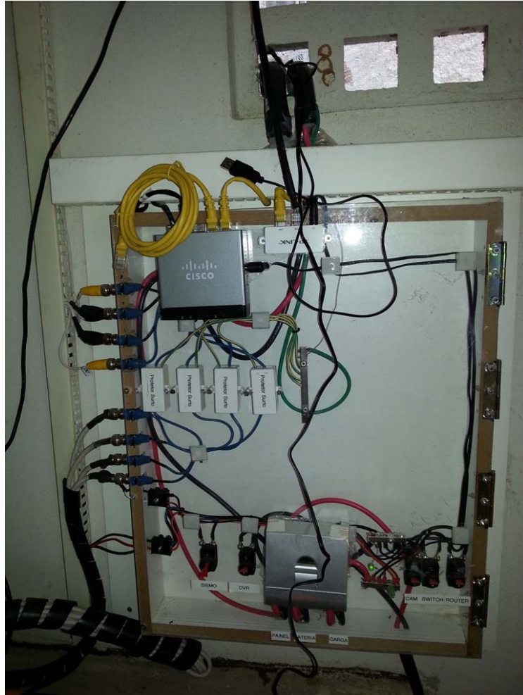
Figura 9 – Painel contendo o switch CISCO (alto, a esquerda), o controlador de carga dos painéis solares (abaixo) e os 04 supressores de surto para as câmeras do CFTV.
