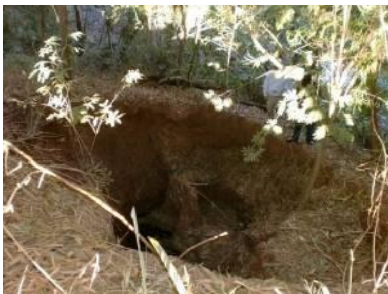
Foto 7.1.1-6 – Ainda no Ponto C4, mais próximo ao curso d'água, há um buraco, com aproximadamente 1,5 m de diâmetro, causado, principalmente pelo escoamento das águas pluviais e a não finalização da galeria.
