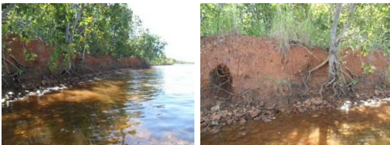
Foto 7.2.2-2 – Ponto SN2 (antigo Ponto 9) - Erosão causada por solapamento da margem devido ao embate das ondas do reservatório.
