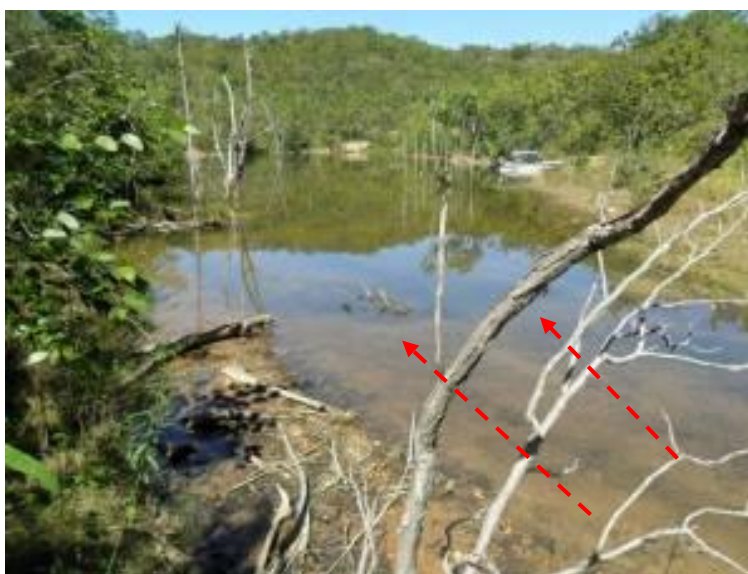
Foto 7.1.3-5 – Ponto SS3. Assoreamento pontual no reservatório causado pelo carreamento de sedimentos advindos destas erosões a montante.
