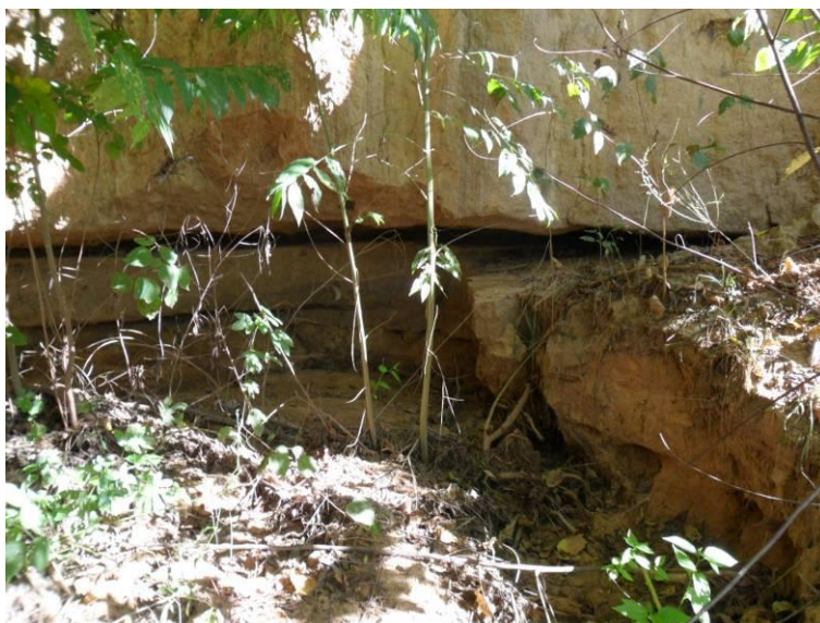
Foto 7.2.5-7 – Ponto JB2. Detalhe da Foto 7.2.5-6 na base do talude. Nota-se que o fluxo de águas também se dá na base do talude, provocando processos de piping , podendo desencadear uma voçoroca neste local.
