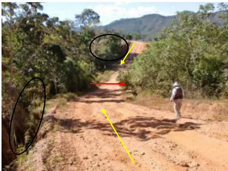
Foto 7.1.3-7 – Ponto SS4 (antigo Ponto 31). Verifica-se erosões na beira da estrada de terra (círculos). As setas amarelas indicam o caminho dos fluxos superficiais pluviais que seguem a topografia do terreno e com isto abrem e intensificam os sulcos carreando sedimentos direito ao reservatório (seta vermelha).
