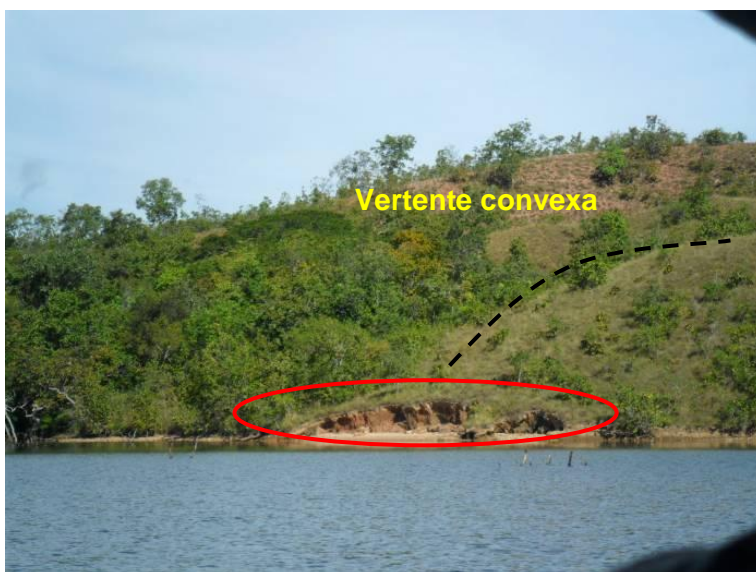
Foto 7.2.2-5 – Ponto SN4. Erosão causada pelo embate de ondas em uma vertente convexa. Com o solapamento das margens, o material de base vai sendo erodido pelas águas e o que está por cima vai desmoronando. Este processo se prolonga até a vertente atingir seu nível de base (rocha), ou até a altura do N.A. máximo do reservatório.
