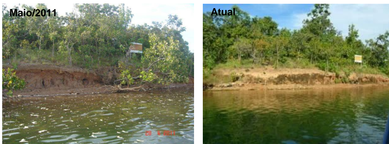
Foto 7.2.2-11 – Ponto SN7 (antigo P6). Erosão localizada na Ilha 75. Nota-se que em relação a maio de 2011 não houve um aumento significativo.
