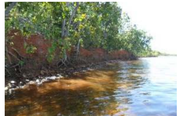
f) Ponto 9 – Processo erosivo pelo embate das ondas na Serra Cana Brava, próximo da estabilização.
