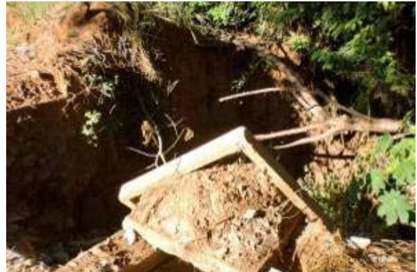
b) Ponto H – Erosão na galeria pluvial do município de Minaçu, na Vila de Furnas.
